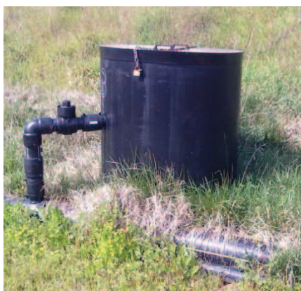
Figura 5 – Foto de poço de biogás
