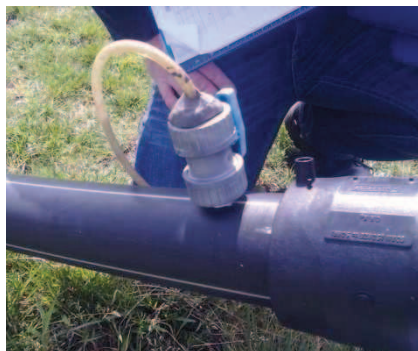
Figura 11 – Pormenor da ligação da tubagem de silicone do equipamento GEM 2000 plus ao ponto de amostragem
