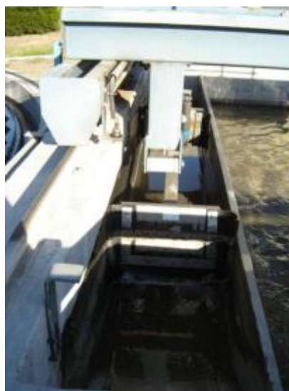
Figura 2.3 - Desengordurador da ETAR da cidade de Viana do Castelo [60].
