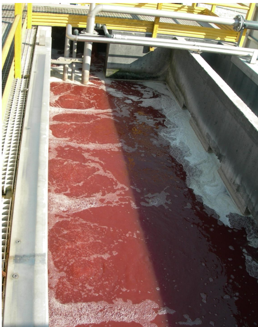
Figura 7: Desengordurador/ desarenador - descarga de matadouro
