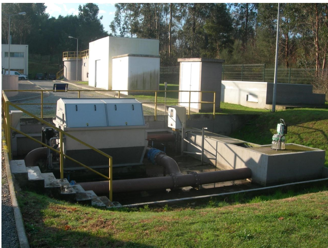
Figura 5: Equipamento de filtração e desinfecção por radiação UV da ETAR de Monção
