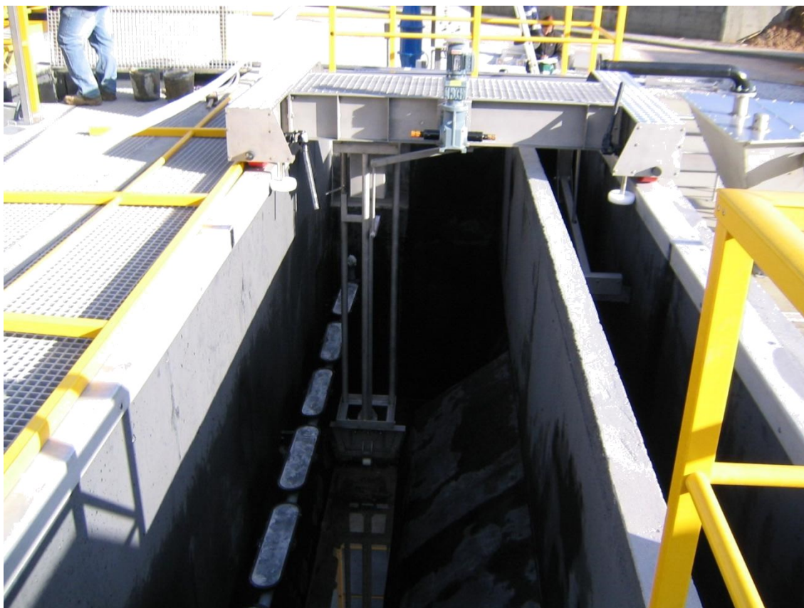
Figura 3: Desengordurador /Desarenador da ETAR de Monção
