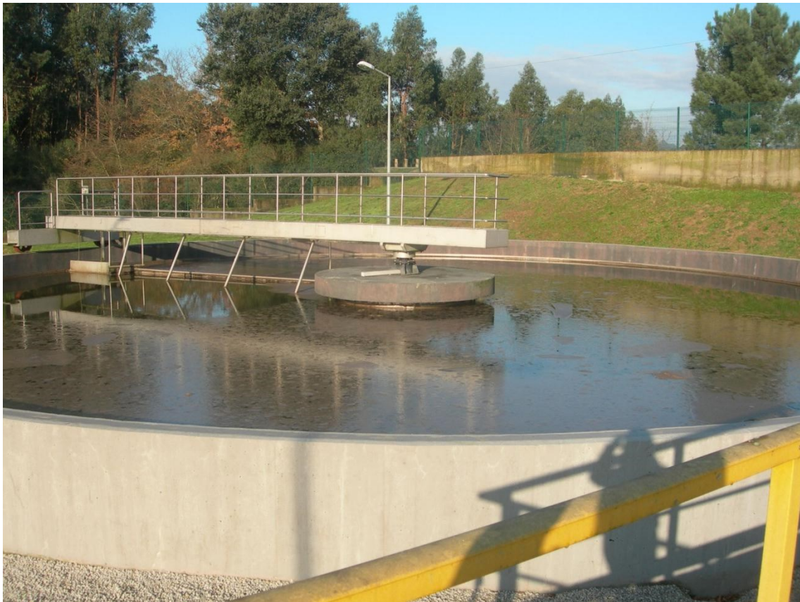
Figura 4: Decantador secundário da ETAR de Monção
