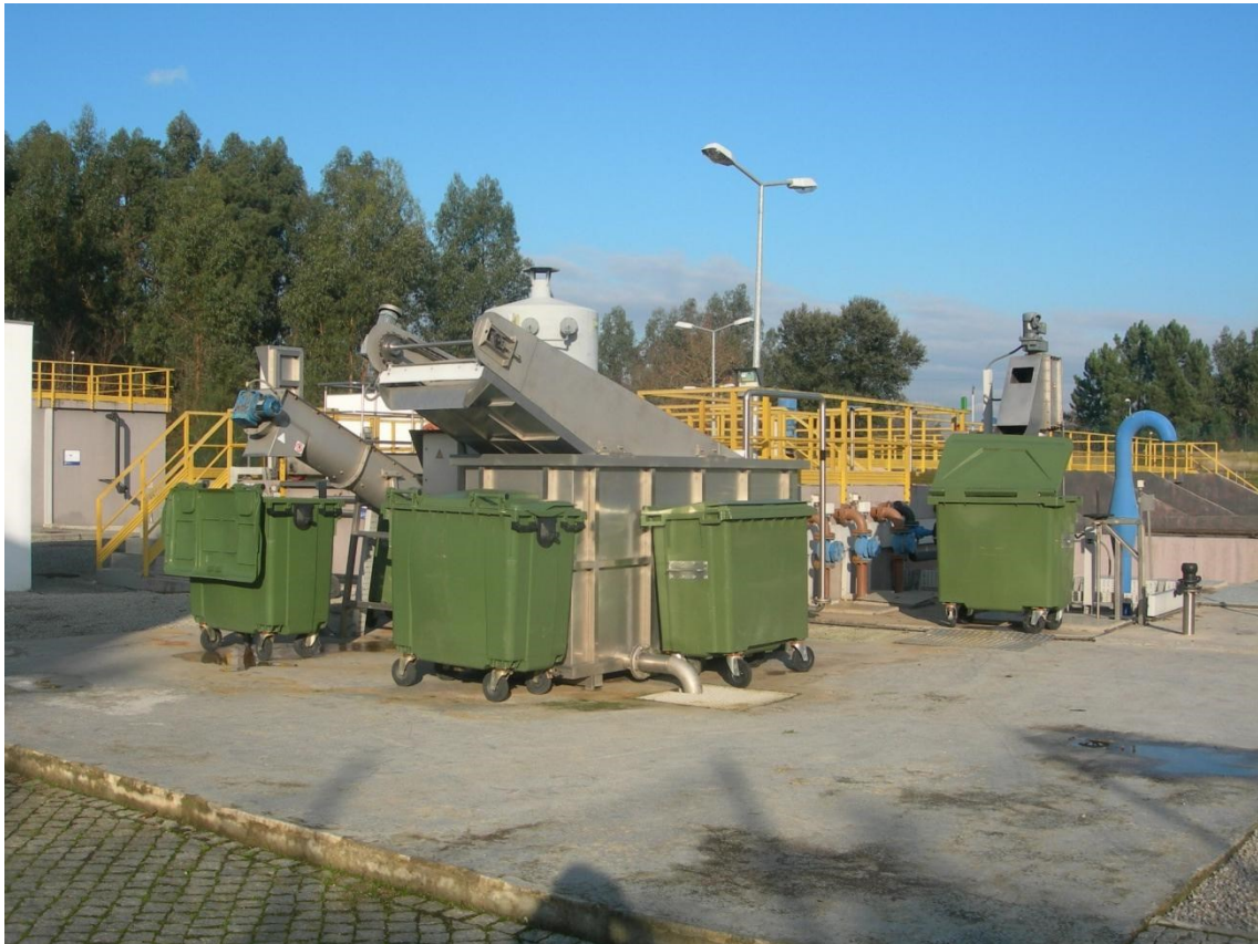
Figura 2: Vista geral do pré-tratamento da ETAR de Monção
