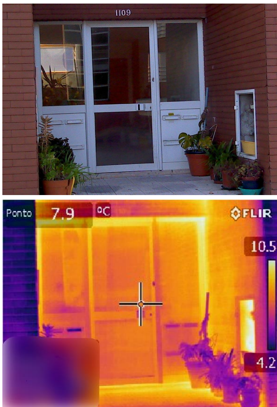
Figura 22 - Mau isolamento das caixilharias
