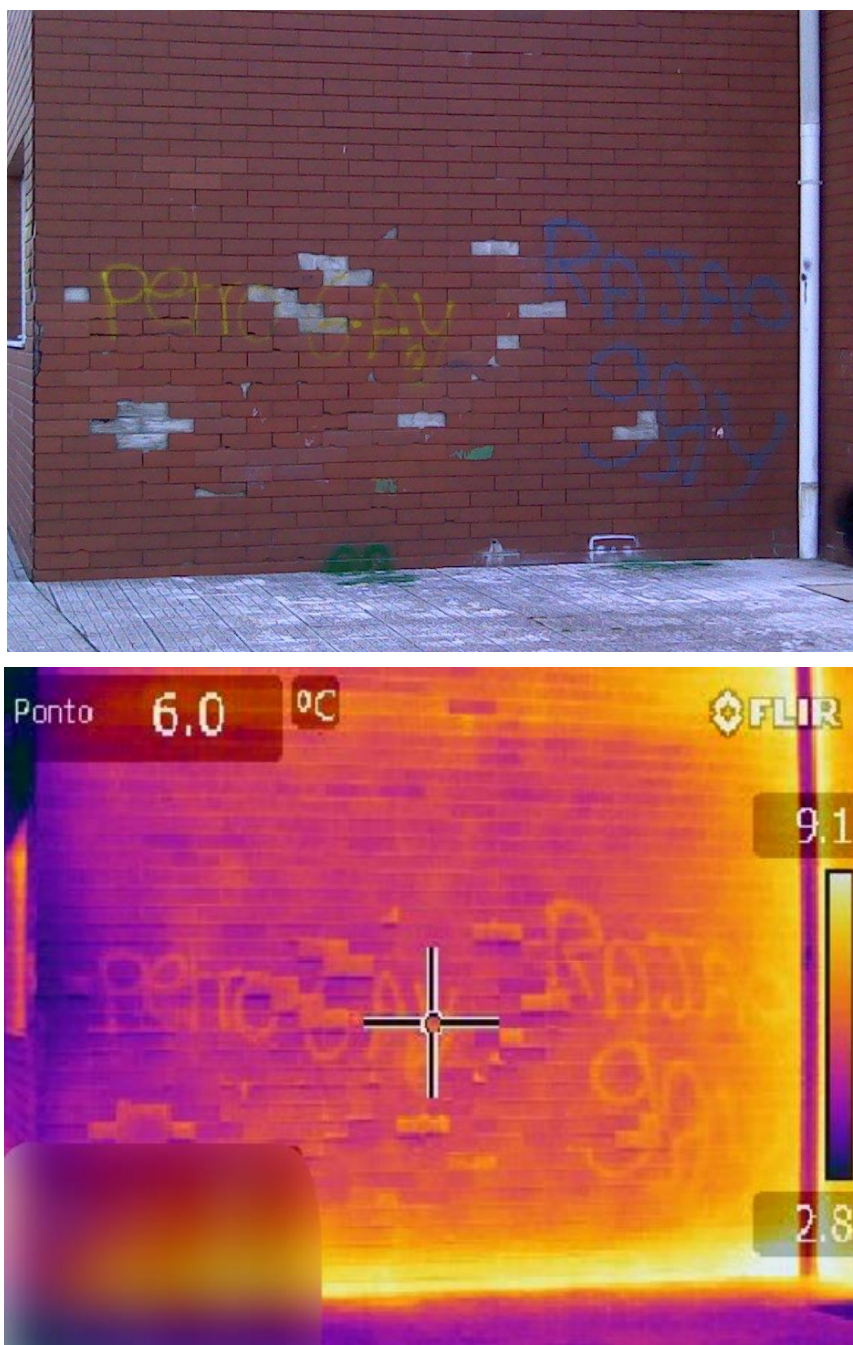
Figura 23 - Presença de Humidades Ascensionais na base do edifício como também junto aos tubos de queda
