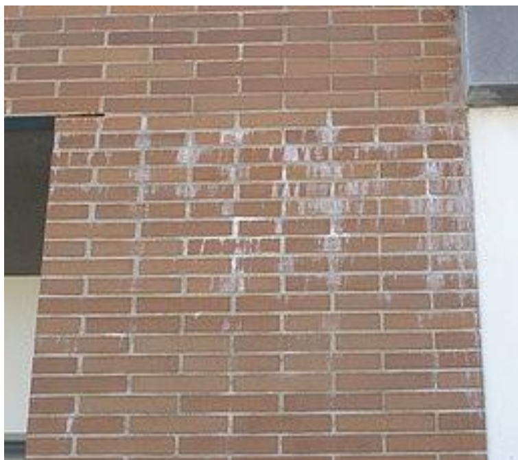
Figura 4 - Eflorescências no Revestimento Cerâmico
