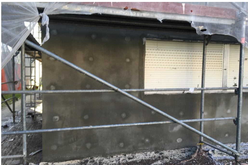
Figura 34 - Segundo barramento armado
