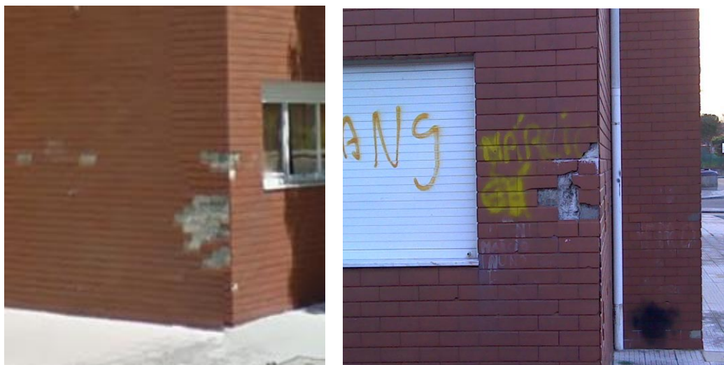
Figura 17 - Destacamento de Ladrilhos
