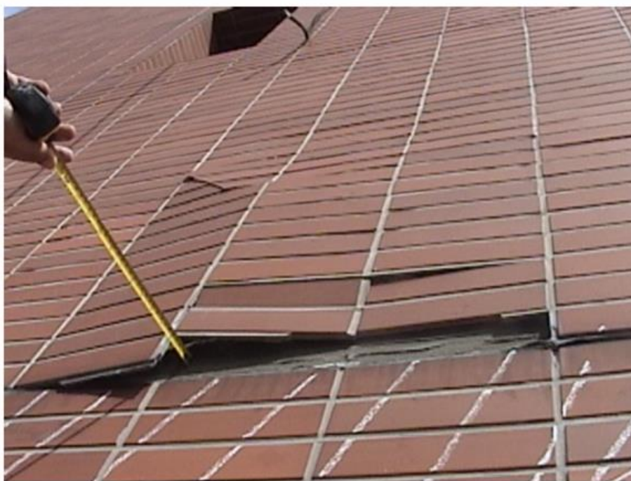
Figura 2 - Descolamento do Revestimento da Fachada (Cabral, 2016)
