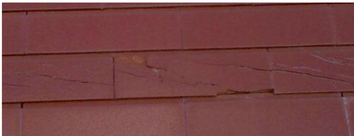
Figura 1 - Fissuração do Revestimento de Fachada (Chaves, 2010)
