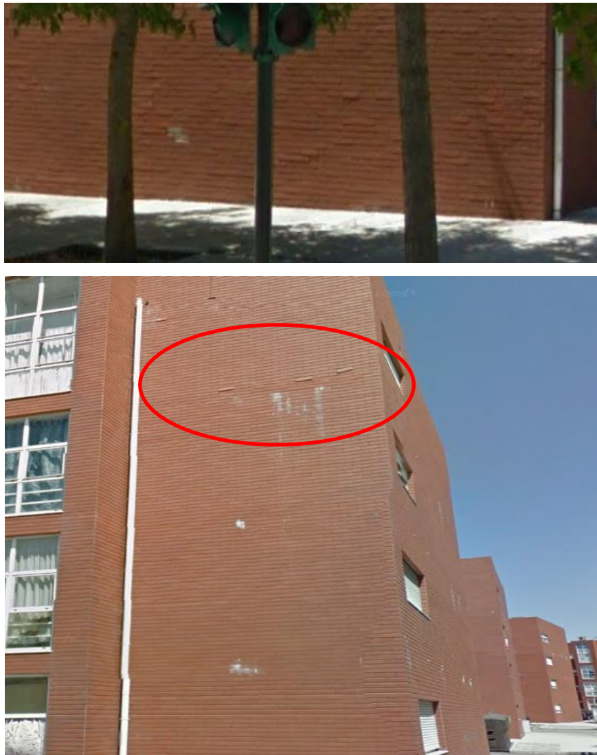
Figura 18 - Ladrilhos na iminência de se destacarem e iminência de perigo para os utentes do edifício
