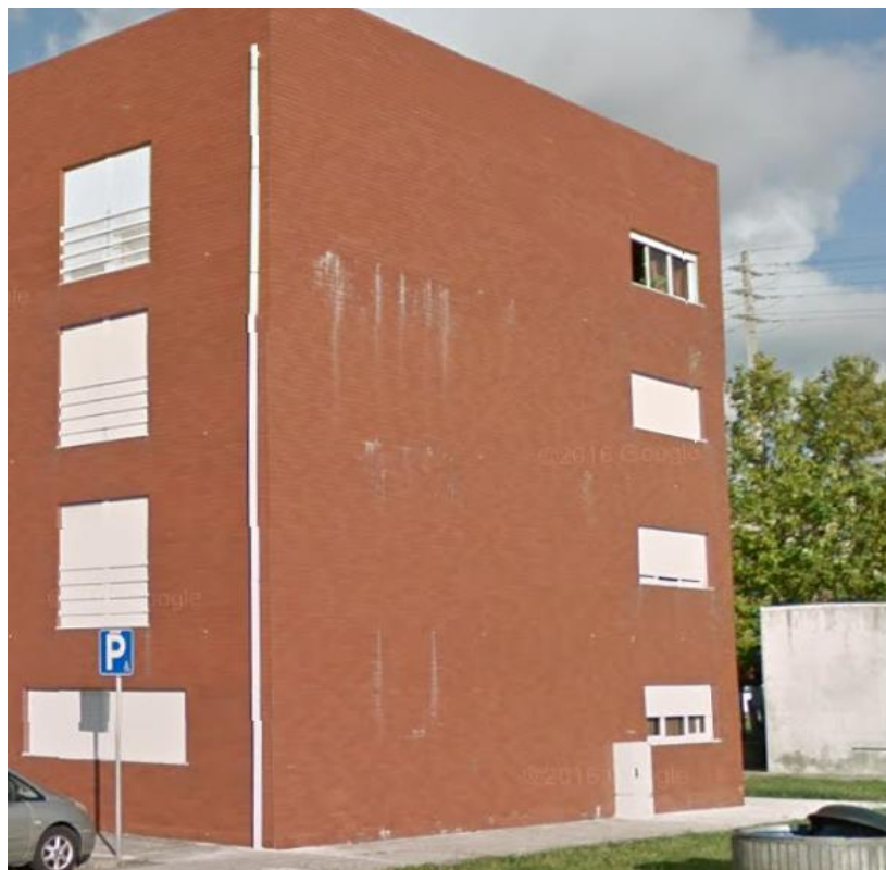
Figura 19 - Presença e escorrimentos e vandalismo na fachada
