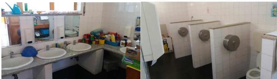
Figura 22. Instalações sanitárias da sala
