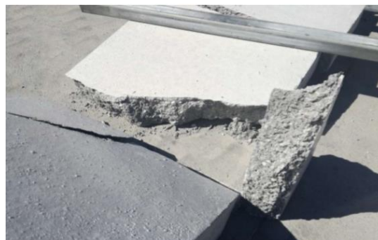
Figura 36 – Foto com pormenor do painel 1 depois do colapso
