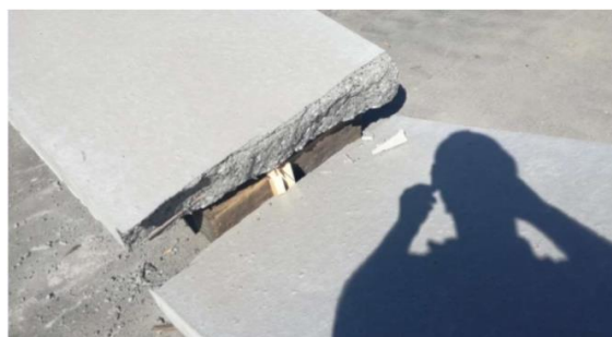
Figura 38 – Foto com pormenor do painel 2 depois do colapso
