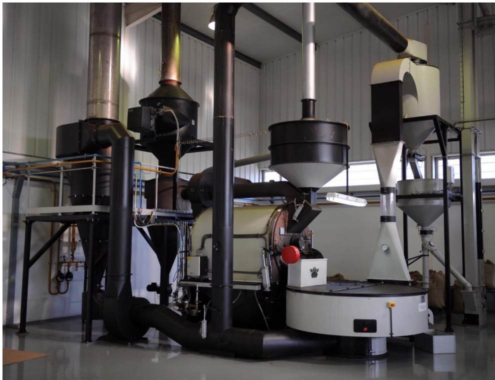
Figura 10 - Sistema de torra: receção, torra e arrefecimento do café e descafeinado.
