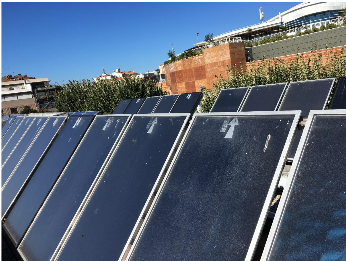
Figura 11 - Painéis Solares Térmicos
