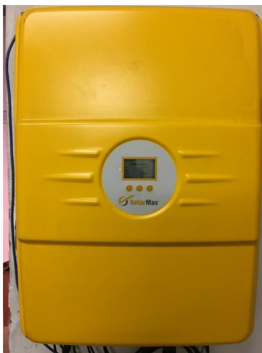
Figura 13 - Inversor Sistema Fotovoltaico
