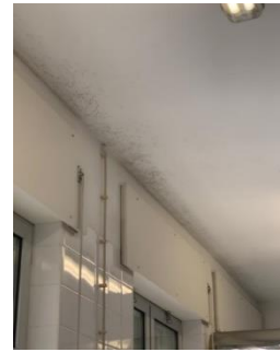
Figura 2 - teto com desenvolvimento de bolor da cantina u.
