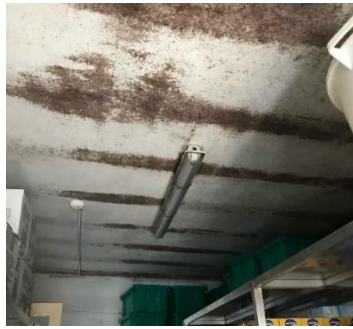
Figura 3- Teto com desenvolvimento de bolor da cantina i.
