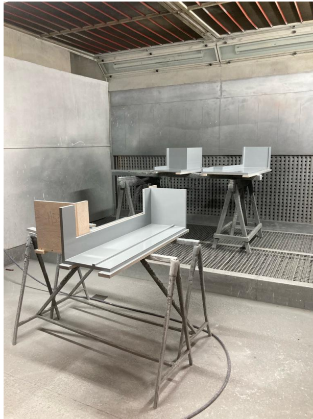
Figura 9 – interior do módulo de pintura. Fonte: António Ribeiro
