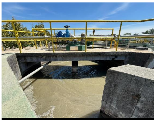
Figura 2.4. Sistema de desarenação
