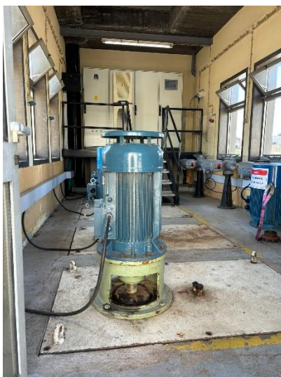
Figura 2.8. Bomba de recirculação das lamas biológicas.
