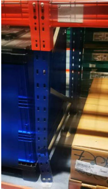
Figura 15. Rack danificada devido a incidente logístico
